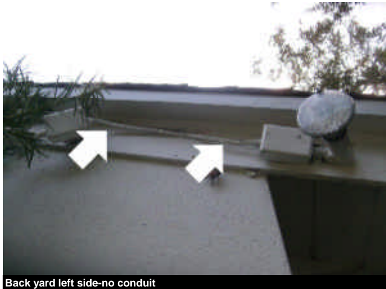
Back yard left side-no conduit
